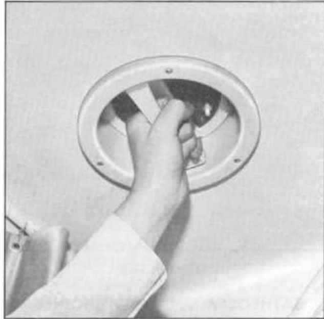
Bathroom Exhaust Fan
